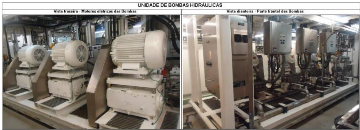
Figura 15: Unidade de Bombas Hidráulicas
