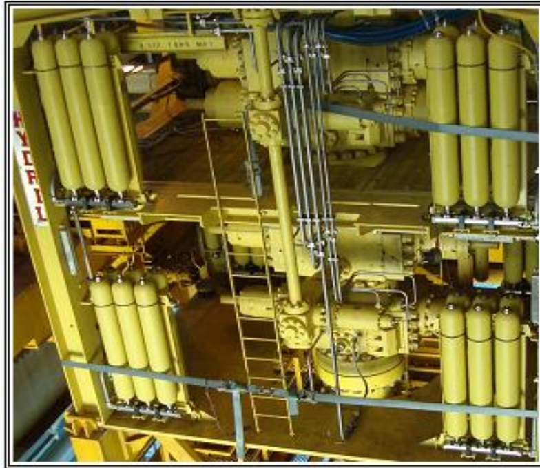
Figura 23: Garrafas acumuladoras de fundo
