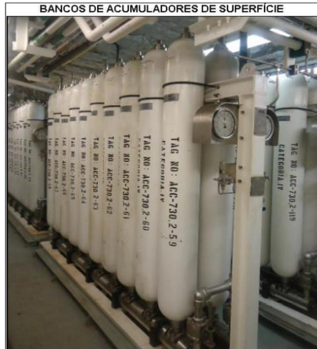
Figura 19: Bancos acumuladores de superfície
