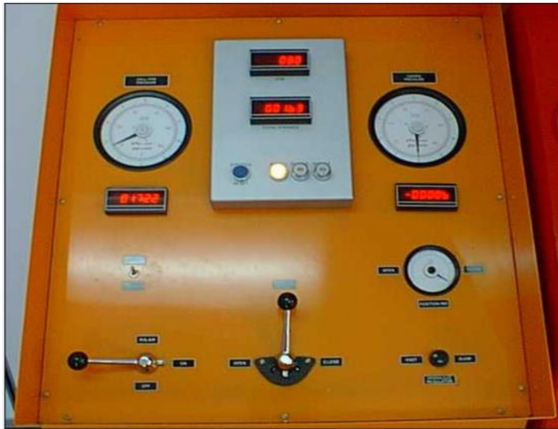
Figura 89: Painel de acionamento remoto do choke
